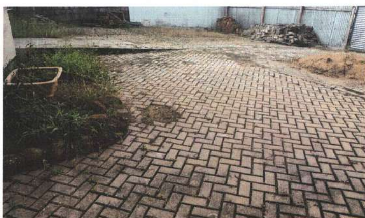
Revisar calçamento e recuperar locais abaulados, e sem piso
