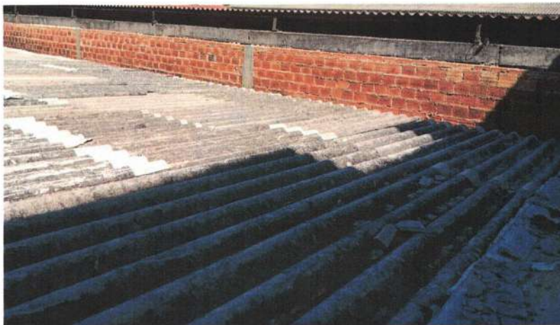
Telhas com remendos, espessura diferentes e danificadas
