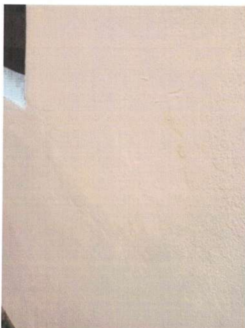
Aplicar textura para amenizar aparência do reboco mal executado
