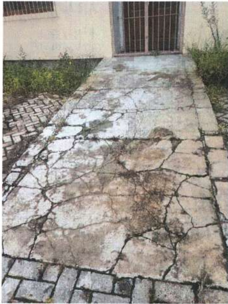
A rampa de acesso deve ser recuperada
