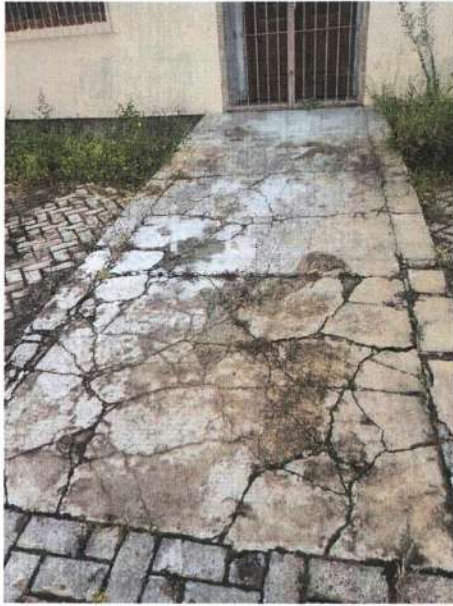
A rampa de acesso deve ser recuperada
