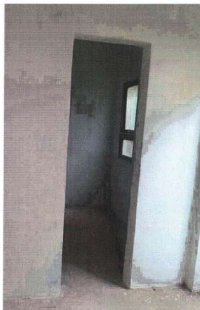
Vão de entrada porta almojarifado em local errado
