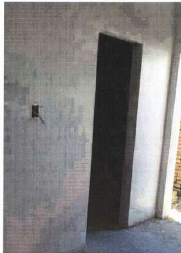
Almojarifado fechar vão e abrir local correto
