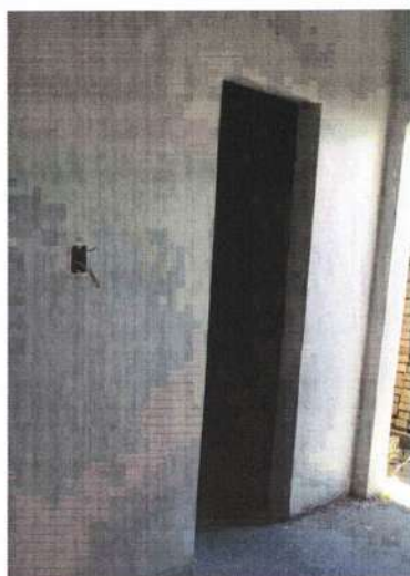
Almojarifado fechar vão e abrir local correto
