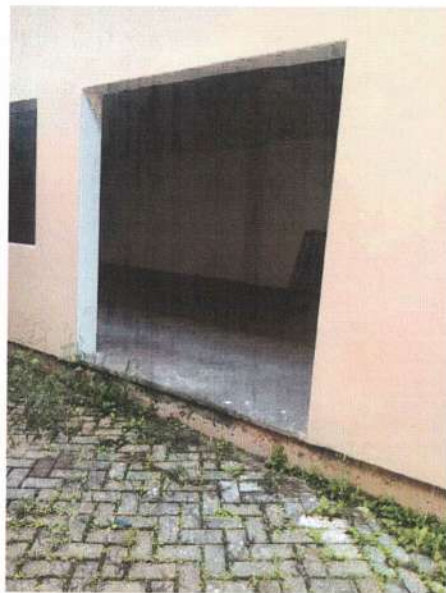
Degrau no acesso ao plenário onde deverá ser construída uma rampa
