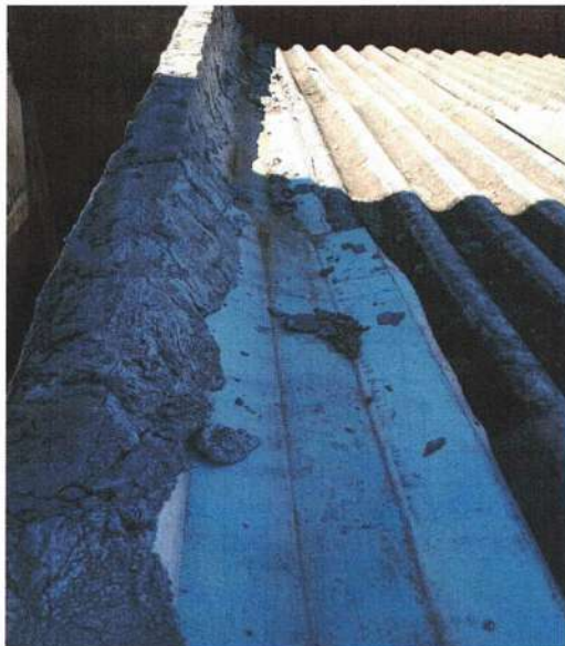
Remoção do revestimento massa que se encontra danificado
