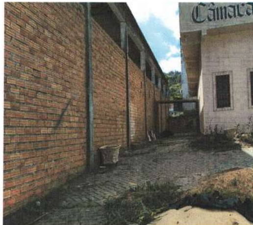
Parede divisória do imóvel que deverá ser salpicado e pintado
