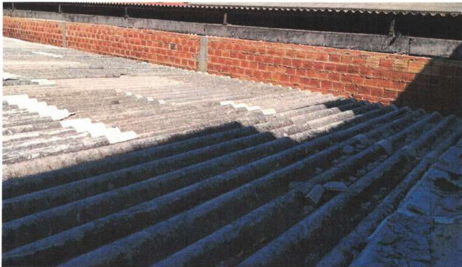
Telhas com remendos, espessura diferentes e danificadas
