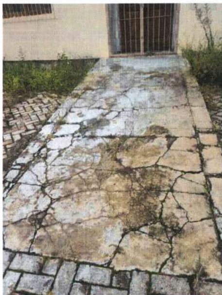
A rampa de acesso deve ser recuperada
