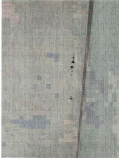
Forro gesso com orifícios
