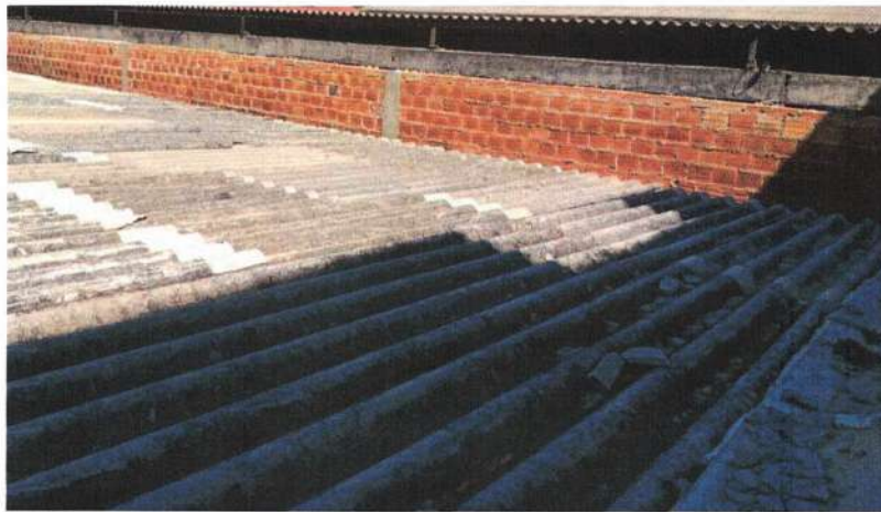
Telhas com remendos, espessura diferentes e danificadas
